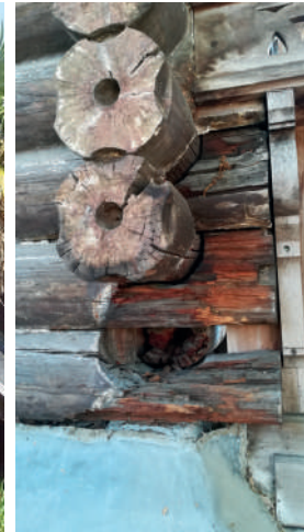
Détail de la dégradation des décors en bois
