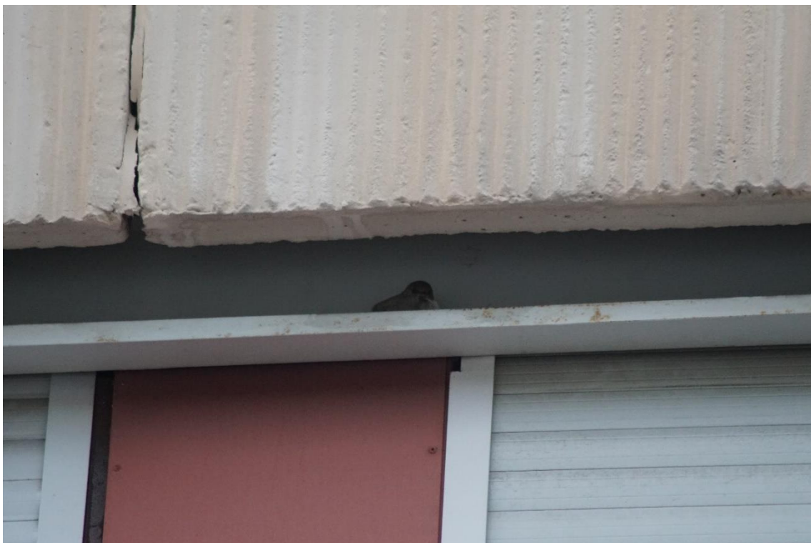
Figure 11 : Hirondelle de rochers posées sur le dispositif de protection des coffres de volets roulants
