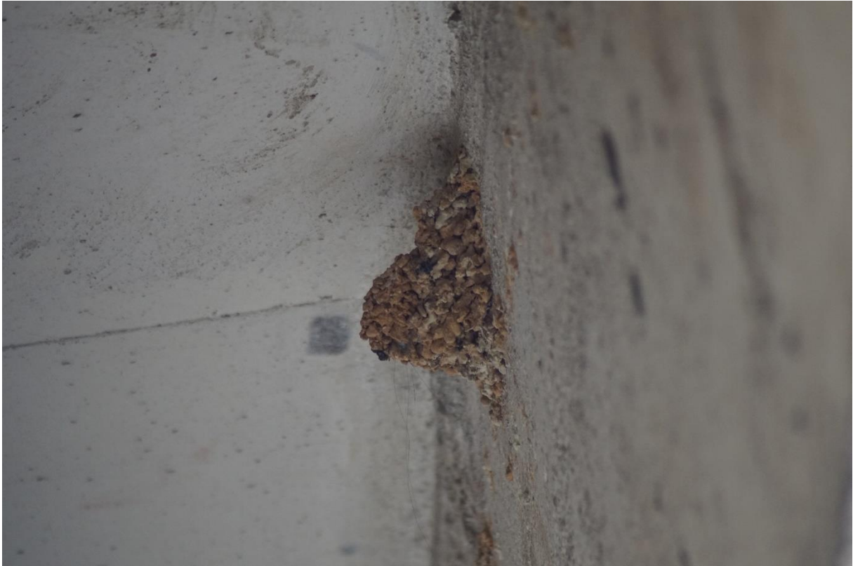
Figure 8 : Nid d'hirondelle de rochers observé sur la façade nord-ouest
